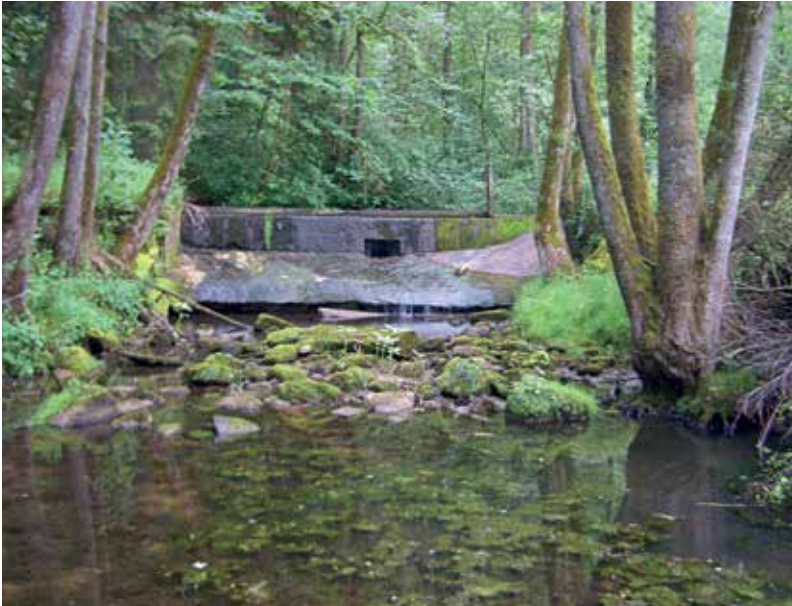
Ausleitungsstrecke der Scherbenmühle bei Wielandsweiler. Verlust der ökologischen Funktion aufgrund mangelnder Wasserzufuhr
