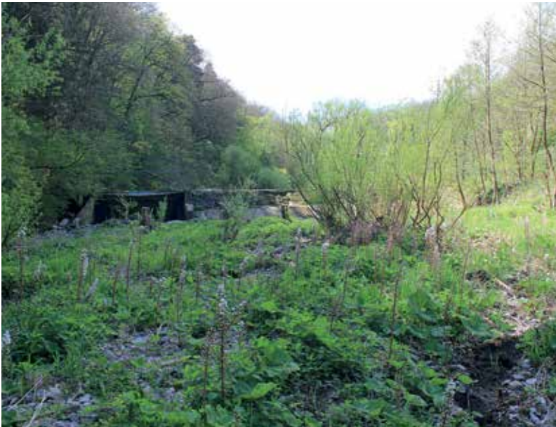
trockengefallene Ausleitungsstrecke unterhalb des Wehres in Neunbronn
