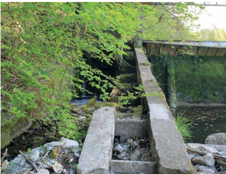
zerfallene, trockengelegte Kammerfischtrappe am Wehr der WKA in Neunbronn
